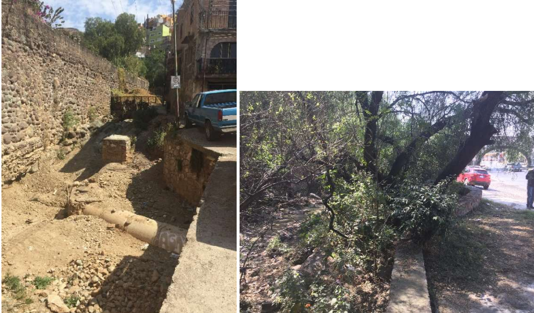
Figura 202. Puntos 3 y 4 de Riesgo por inundación.
