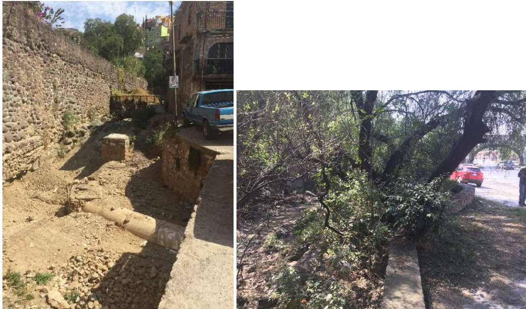
Figura 202. Puntos 3 y 4 de Riesgo por inundación.
